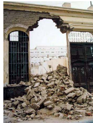
Fig. 10b – Falla por volteo.
