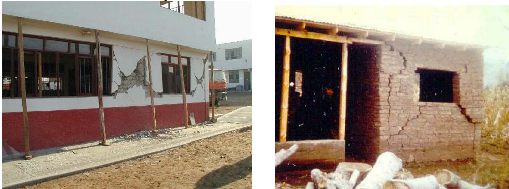
Fig. 11 – Grietas diagonales por corte en los muros.
