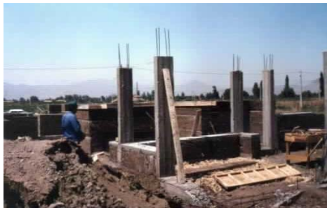
FOTO 1 Detalle ejecución muros de tapial. Es posible observar los pilares de concreto con rafas del mismo material.
