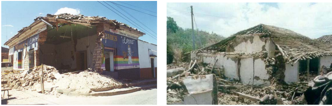
Fig. 4 – Daños en viviendas de tierra. Terremotos de El Salvador (1982) e India (1987).
